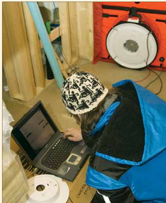
Med en medbrakt datamaskin styrer forsker Tormod Aurlien den avanserte luftlekkasjemålingen. Dataprogrammet justerer selv viftas hastighet slik at korrekt undertrykk på 55 pascal oppnås.
