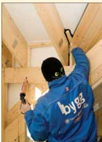
Byggeplassleder Christian Skau-Jacobsen fikk det travelt med fugepistolen da undertrykket nådeløst avslørte flere luftlekkasjer, som her i gradrenna i taket.
